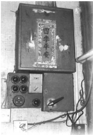
圖2-1: 舊式家居電力裝置
