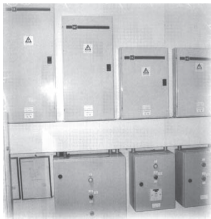
圖2-4: 現代配電設備
