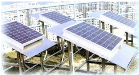
圖5-1: 太陽能光伏發電板
