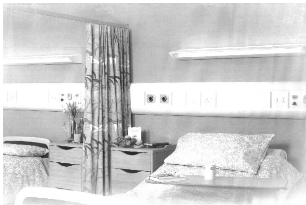
圖3-3：病房電線槽裝置
