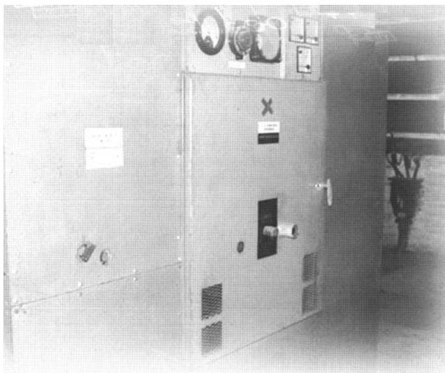
圖4-1: 舊式配電掣櫃
