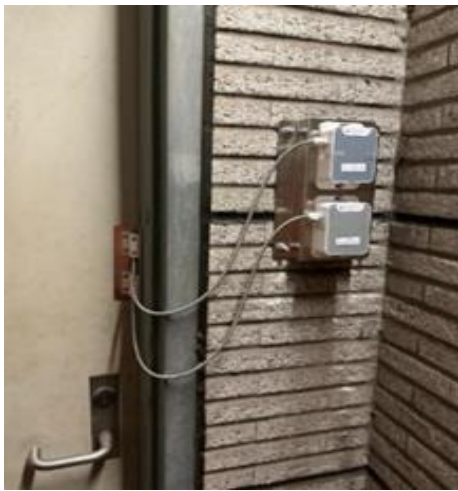
Fig. 8 - Trackside Access Door Sensor
